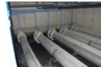
Bild: © Dobringer/ Die Wärmerückgewinnung im Hummelhofbad in Linz (Linz AG) spart täglich zwischen 750 und 1000 kWh an Wärme ein
